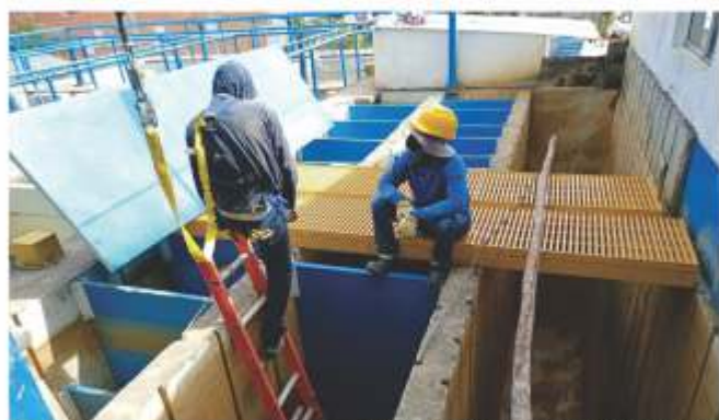
Cambio en las placas de los floculadores Durante
