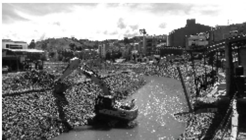
Canalización quebrada La Marinilla
